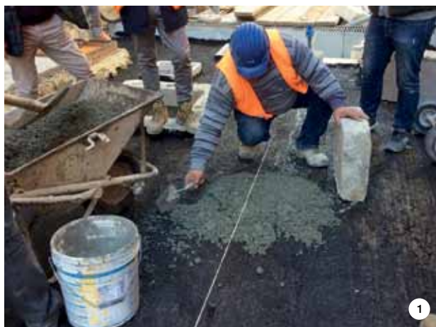
FOTO 1 e 2. Posa delle basole sul massetto d'allettamento realizzato con MAPESTONE TFB 60. FOTO 3. L'intervento è terminato con la fugatura effettuata con la malta premiscelata MAPESTONE PFS2 VISCO.
