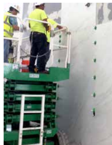
Paneles/losas de losetas de porcelana calibrada en un muro interior
