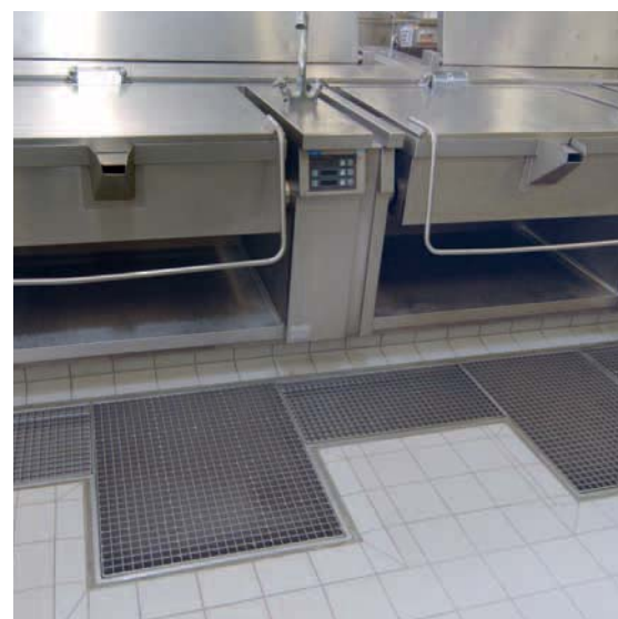
Im Bereich der Bodenabläufe ist der Belag einer extrem hohen mechanischen und chemischen Belastung ausgesetzt
