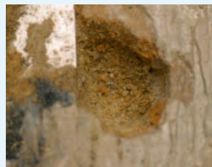
Zerstörung der Abdichtung und der Rinnenvermörtelung durch chemischen Angriff
