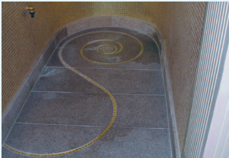
Verfleckungen im Naturstein durch Staunässe auf der Abdichtungsebene und Kalkablagerungen auf der Belagoberfläche
