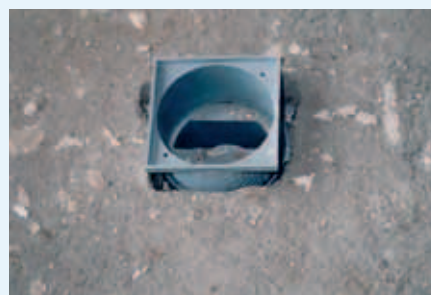
Für Verbundabdichtungen konstruktiv ungeeigneter Bodenablauf
