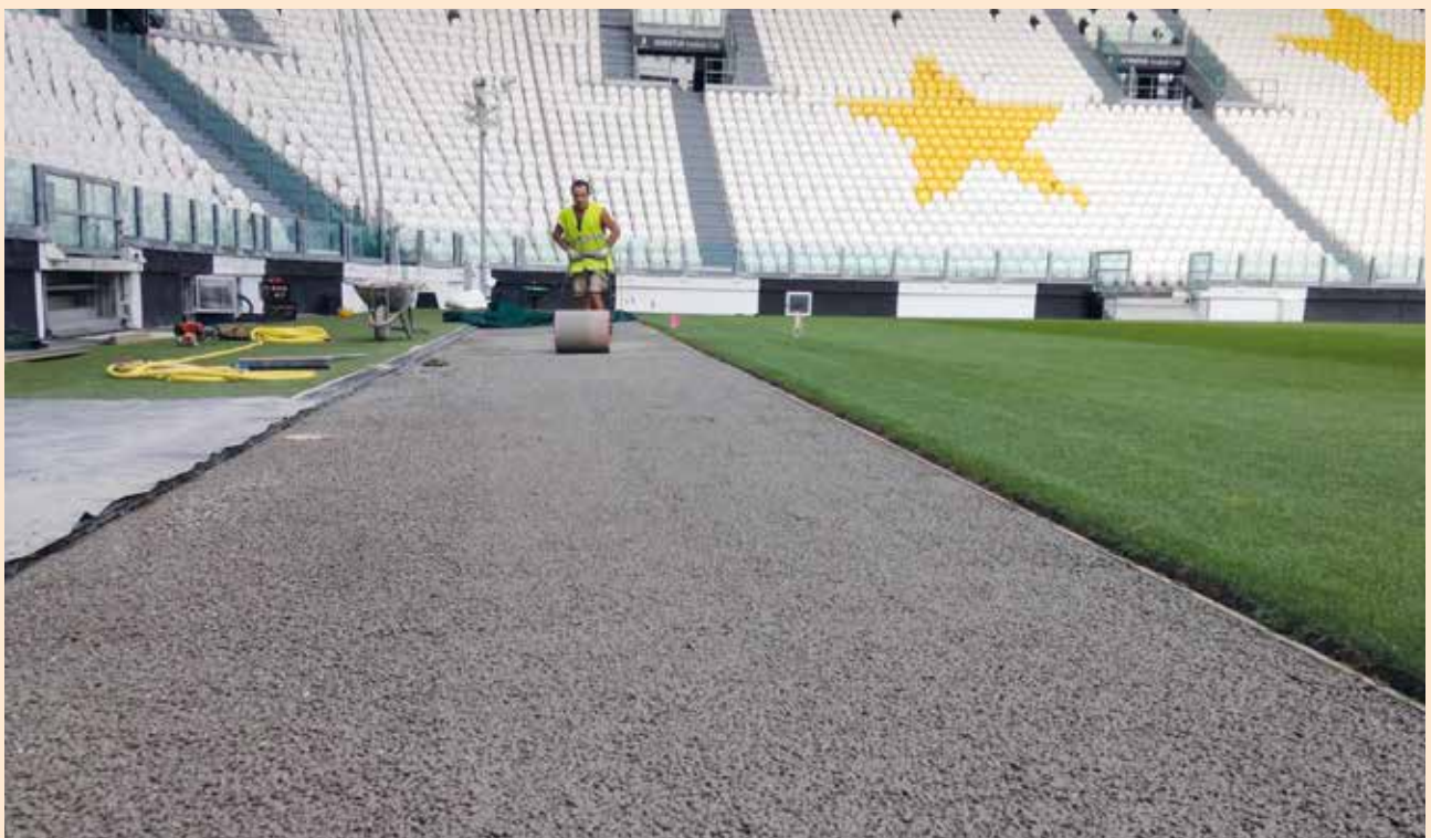
Im Stadion von Juventus Turin wurde die Auslaufzone rund um den Platz mit MAPEI-Produkten saniert.
