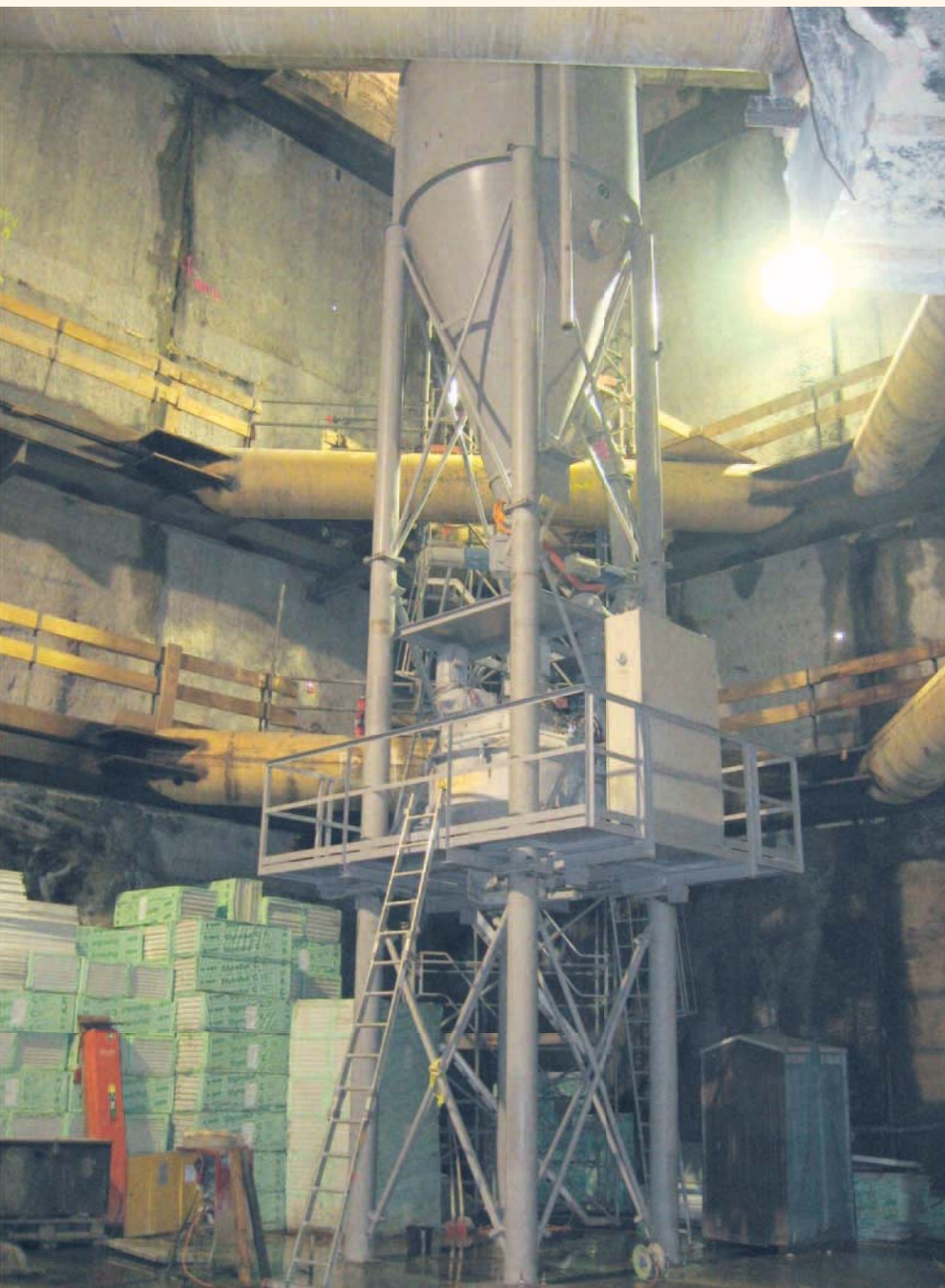
Silo für Trockenbeton mit unterhalb angeordneter Mischeinheit (ARGE U55)
