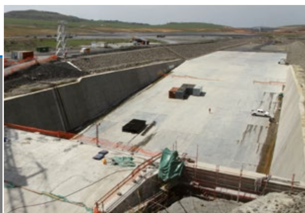
Centrale idroelettrica di Ingula (South Africa)
