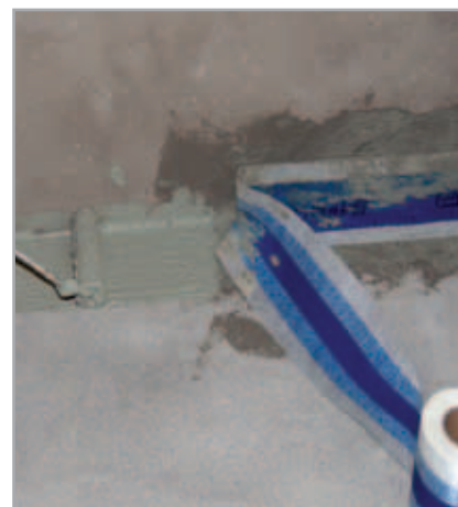
Fig. 3.8 - Esempio di sigillatura ed impermeabilizzazione dei raccordi tra superficie orizzontale e verticale mediante MAPEBAND
