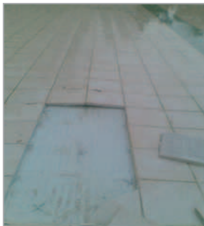
Fig. 5.1 - Piastrelle in compressione e distaccate dal supporto
