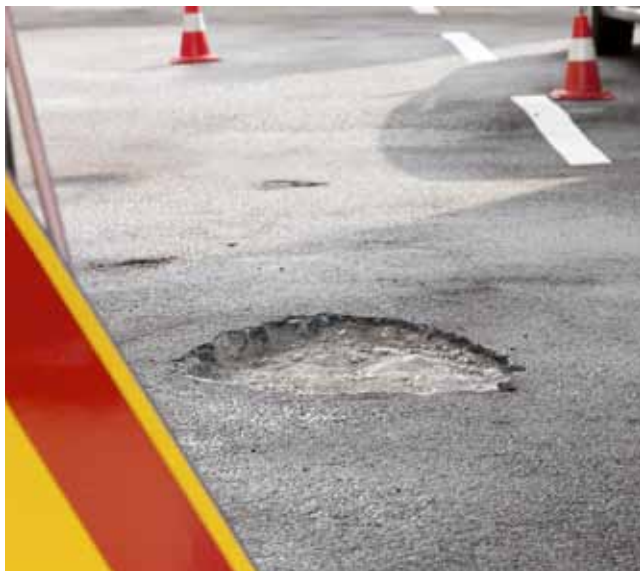
1. Buca stradale pronta per essere riparata
