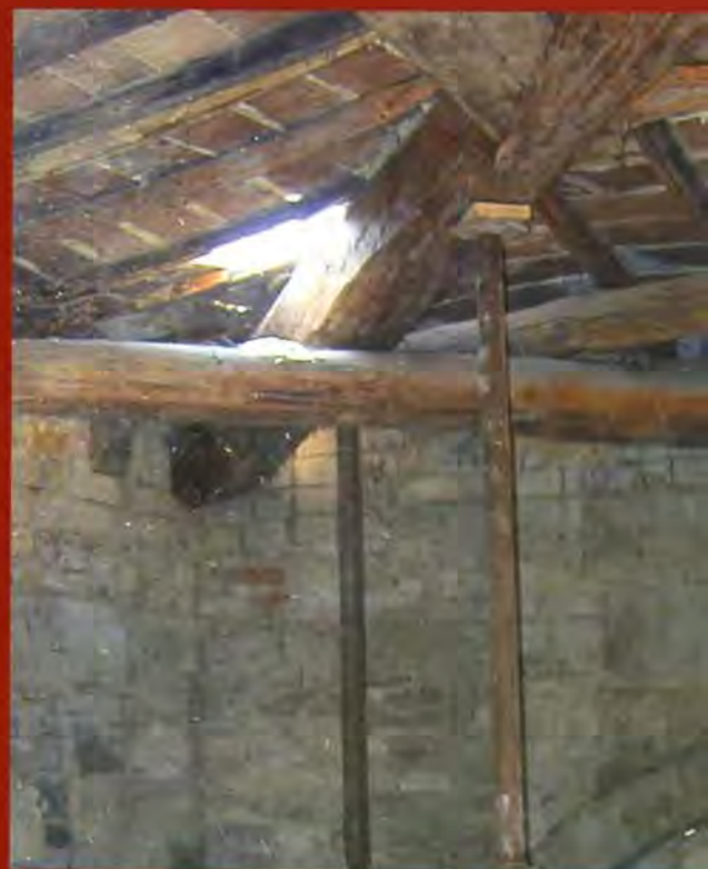
FIGURA 2 - Degrado di tipo strutturale: rotture, sconessioni, deformazioni eccessive
