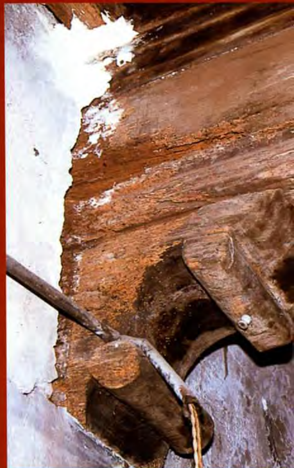
FIGURA 4 - Appoggio di capriata con catena visibilmente degradata da carie
