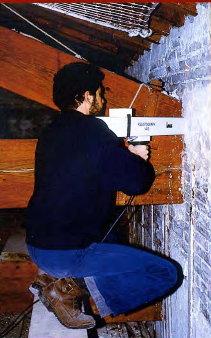
FIGURA 3 - Analisi diagnostiche accurate, di tipo visivo e strumentale non distruttivo, consentono di quantificare l'estensione del degrado senza ricorrere allo scalzamento delle testate
