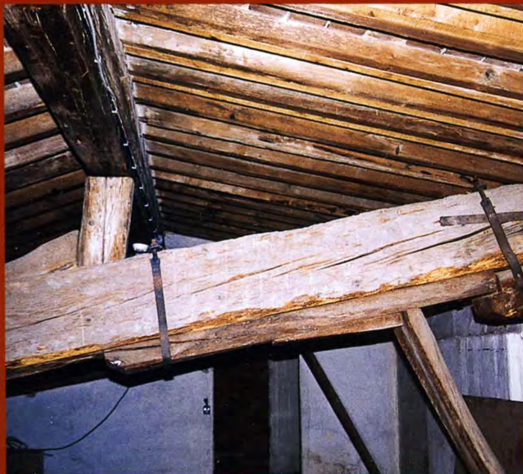
FIGURA 5 - Trave principale di una copertura con evidente attacco da insetti xilofagi localizzato sullo smusso inferiore
