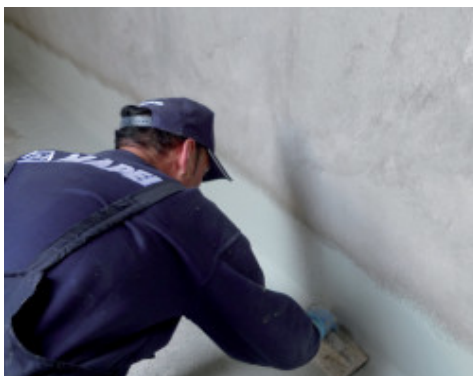
Mapelastc Foundation steso a spatola in un intervento di impermeabilizzazione in contropinta
