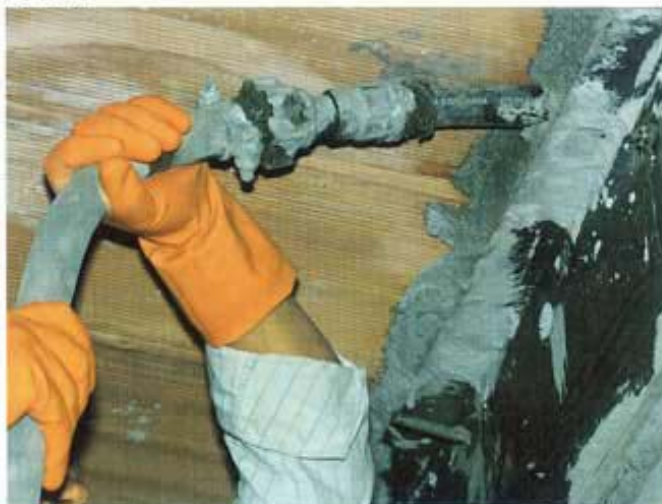
Foto 3-4 Dopo aver posizionato la lamiera pressopiegata utilizzata come cassaforma si è proceduto a preparare la malta in betoniera e alla sua applicazione mediante iniezione
