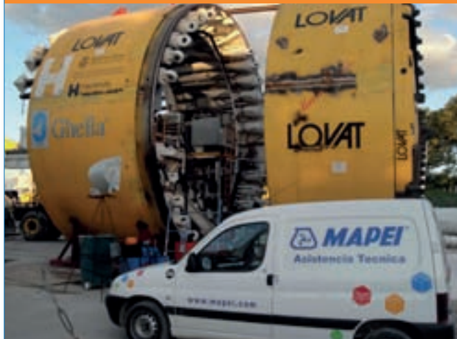
TUNNEL ARROYO MALDONADO, BUENOS AIRES, ARGENTINA Impresa: Ghella Argentina - Committenza: Gobierno de la Ciudad de Buenos Aires - Direzione lavori: Geodata, Cadia Prodotti utilizzati: MAPEQUICK CBS SYSTEM 1 e 4, POLYFOAMER FP, MAPEBLOX T/S, FOAMJET F, MAPEGROUT TGO, MAPEGROUT RAPIDO, MAPEGROUT T/BA
