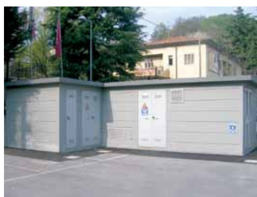
DALL'ALTO. Lo Studio di progettazione di Italcabine, il trasporto delle cabine e, in basso, le cabine messe in opera.
