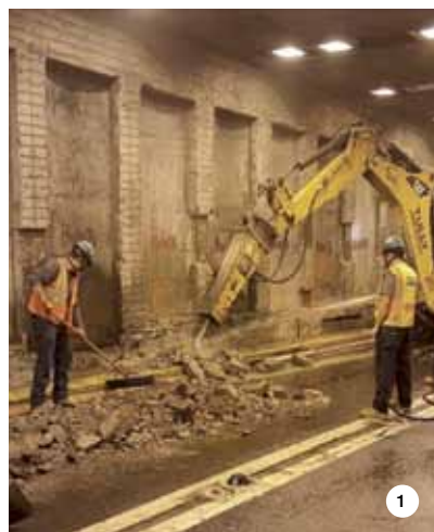
FOTO 1. Il tunnel dopo il passaggio dell'uragano Sandy.
