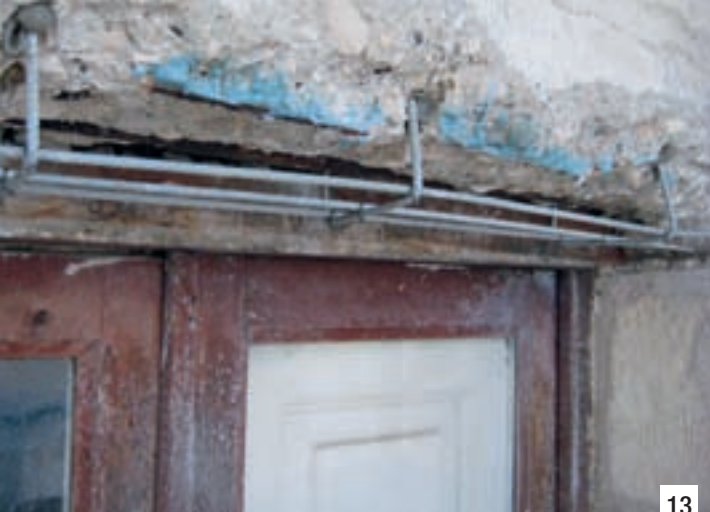
Foto 13. Le parti ammalorate delle cornici sono state rimosse e i ferri sono stati passivati con MAPEFER 1K. La ricostruzione delle sezioni è stata effettuata con MAPEGROUT BM oppure con MAPEGROUT COLABILE GF, GHIAIETTO 6-10 e MAPECURE SRA.
