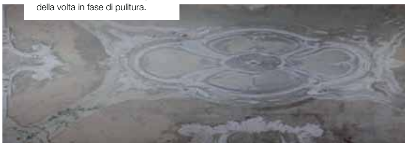
APPARTAMENTO DELLA DUCHESSA DI GENOVA: parte della volta in fase di pulitura.
