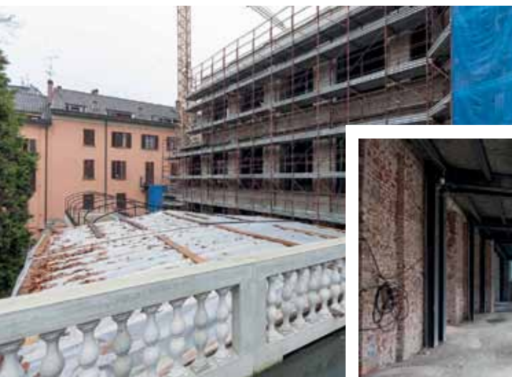
A SINISTRA. Un'immagine della facciata durante gli interventi di risanamento e restauro conservativo.
