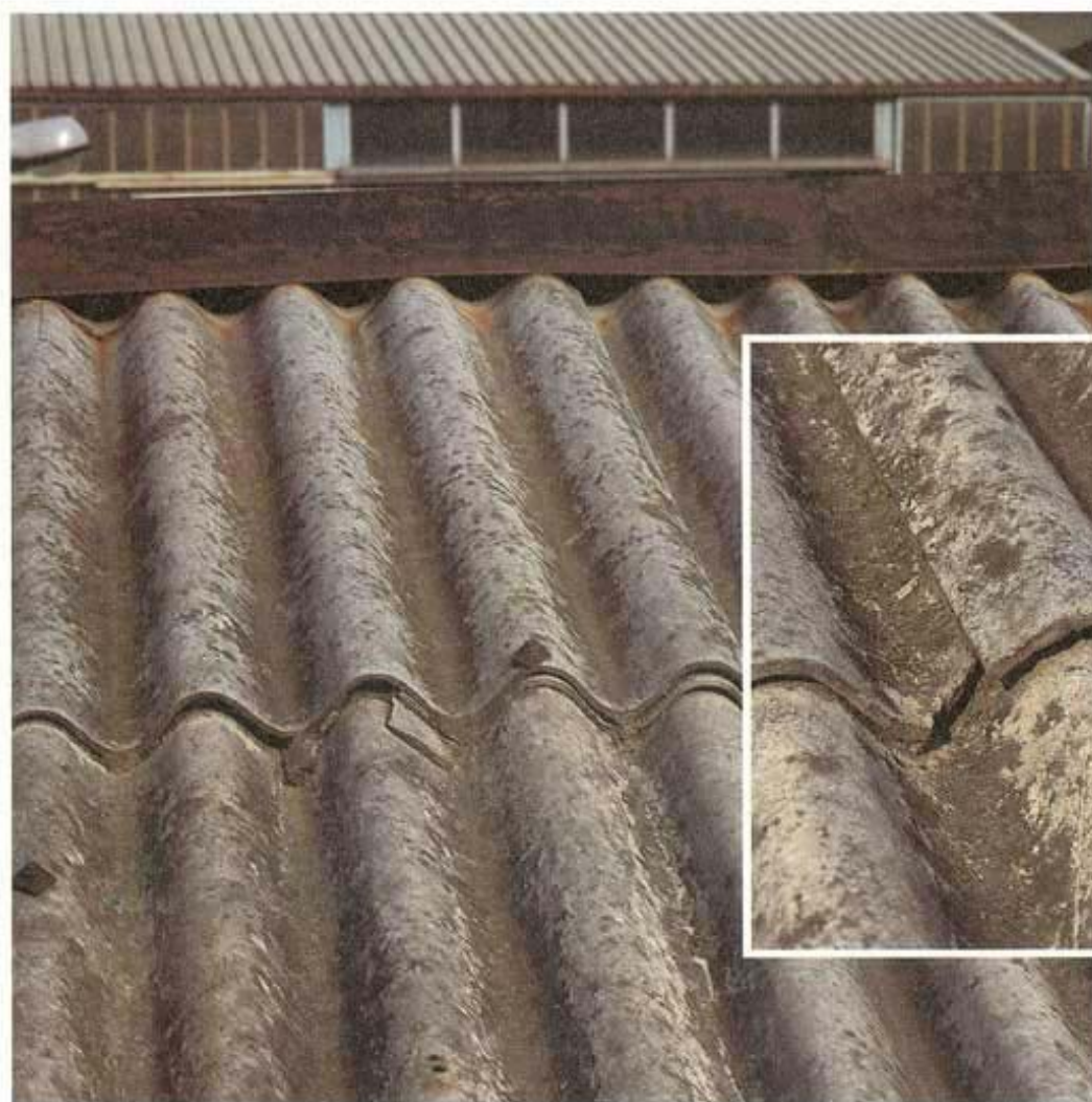
Tipica copertura di cemento amianto degradata. Ne esistono milioni di metri quadrati. Nel riquadro un particolare del tetto
