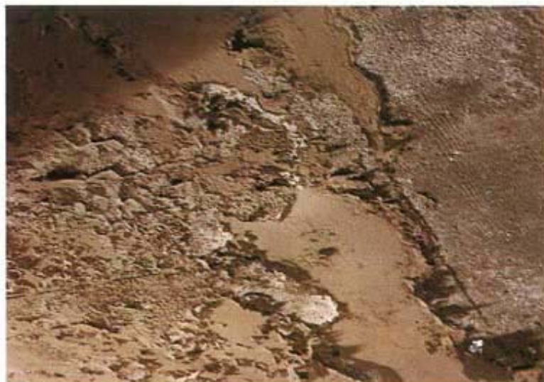
Ecco gli effetti del dilavamento dell'idrossido di calcio nella faccia inferiore della soletta portante di un terrazzo.
