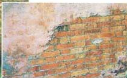
Foto 2 Stato di degrado del ponte prima dell'intervento di ripristino
