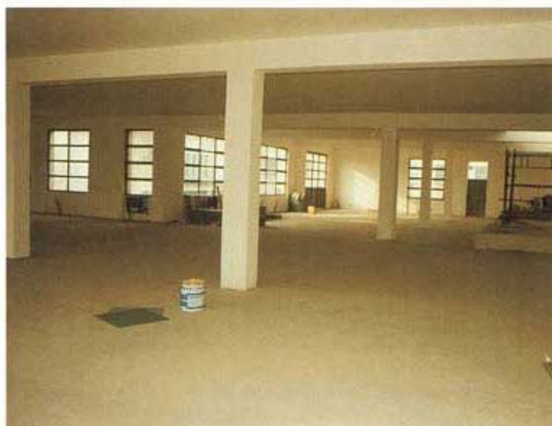
Preparazione e rasatura del massetto in Mapecem prima della posa del pavimento resiliente
