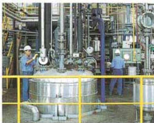
Un reattore chimico per i processi di esterificazione
