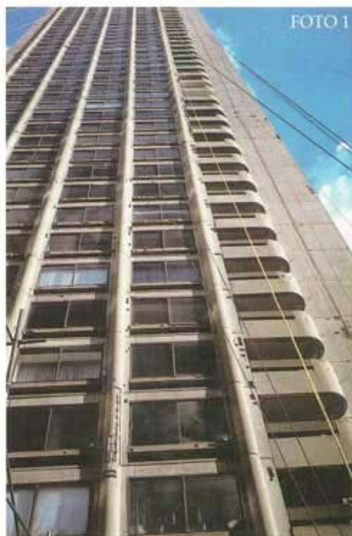
Foto 1: grattacielo a Boston, corrosione da carbonatazione
