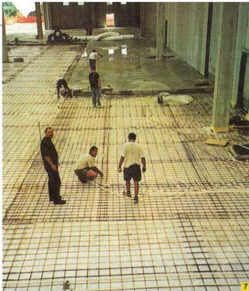
Foto 7 – Vista di un campo di getto terminato e dei campi adiacenti pronti per essere gettati
