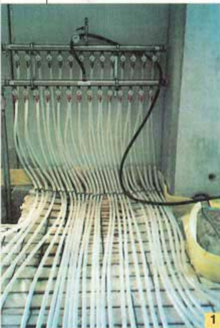
Foto 1 - Uno dei tanti collettori di distribuzione
