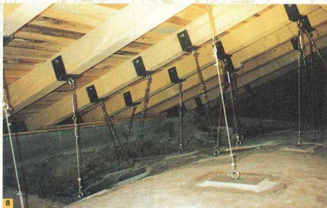
Foto 10. Ripristinata la complanarità delle porzioni delle volte cedute, si è proceduto alla sigillatura delle fessure con il legante MAPE-ANTIQUE MC.
