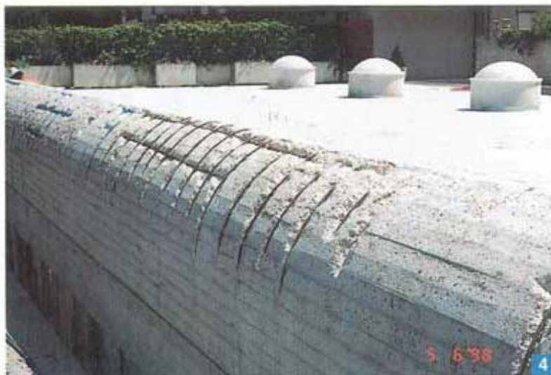
Foto 4. Particolare dei setti curvi del corpo basso. Sono evidenti le scanalature per l'asportazione delle impurità e delle sostanze grasse dalle armature.
