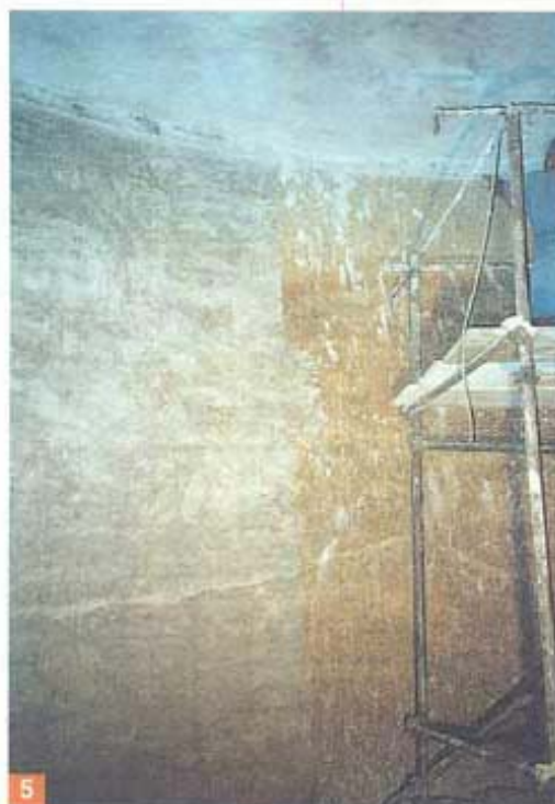
Foto 4. L' avanzato stato di degrado visto dall'interno del serbatoio.
