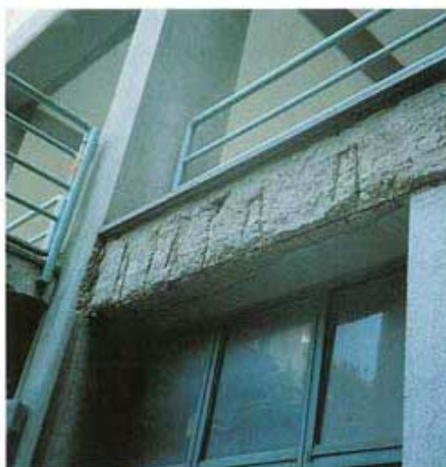
Particolari di alcune parti degradate dell'edificio
