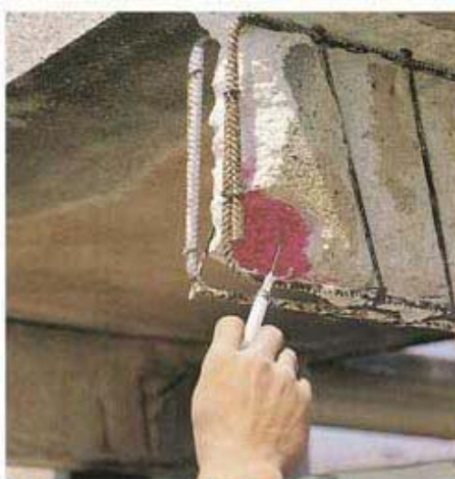
Profondità di carbonatazione con fenoltaleina
