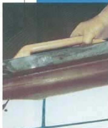
Stesura con spatola metallica di Ultraplan su pavimento esistente in ceramica previa applicazione di Mapeprim SP
