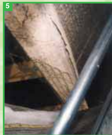
Foto 5. Distacco parziale della "malta di posa" dal sottostante "calcestruzzo di regolarizzazione" senza evidenziare il "crollo" del rivestimento in mosaico vetroso.
