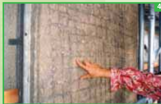
Foto 4. Completo distacco della "malta di posa" e, quindi, del rivestimento vetroso lasciando in vista il "calcestruzzo di regolarizzazione".
