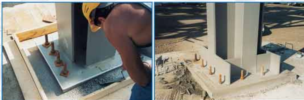
Nelle due foto a lato: Inghisaggio dei pilastri di acciaio nei basamenti con Mapefill.
