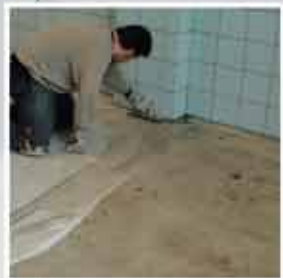
Alcune fasi di lavorazione del ciclo Mapefloor System 33. Stesura del Primer SN.
