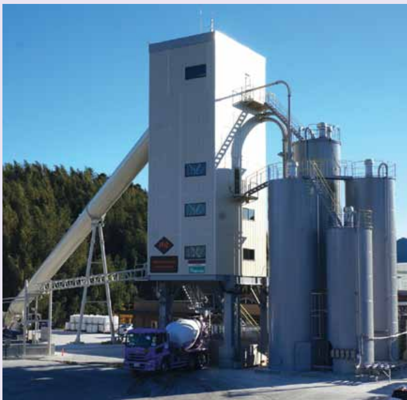
Il nuovo impianto di NR-MIX a Nagaoka, nella prefettura di Shizuoka, dove viene prodotto il calcestruzzo ECON, composto da aggregati prodotti dal calcestruzzo reso trattato con RE-CON ZERO EVO.
