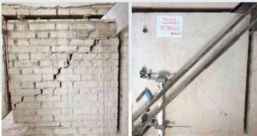
Confronto tra la modalità di rottura del pannello non rinforzato (a sinistra) e rinforzato con malta PLANITOP INTONACO ARMATO (a destra).
