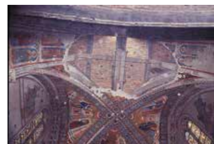
A földrengést követő boltozati károk. Vault damage following the earthquake.
