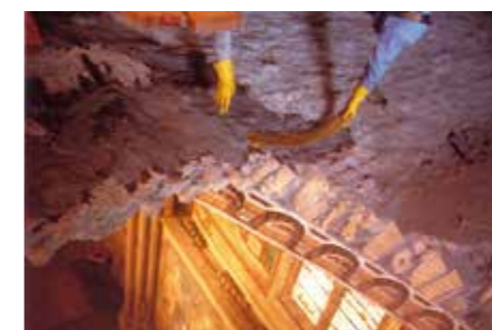
A boltozat külső oldali megerősítése FRP-vel. Extradossal strengthening of the vault with FRP.
