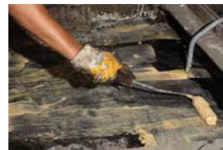
FRP rendszer alkalmazása a boltozatok megerősítésére. Application of FRP System to strengthen a vaulted ceiling.
