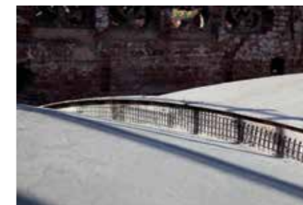
A boltozat külső oldali megerősítésének közeli képe. Detailed view of strengthening on the extrados.
