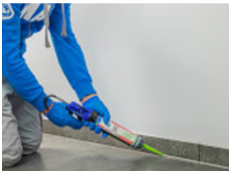
Tömítse a lábazati szegély és a padlóburkolat közötti hézagokat a megfelelő rugalmas Mapei tömítővel
