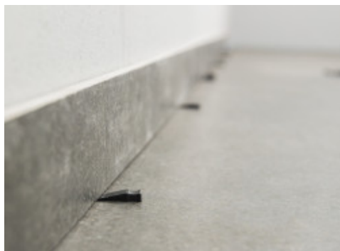
Helyezze el a lábazati szegélyt a helyiségben anélkül, hogy az közvetlen kapcsolatba kerülne a padlóburkolattal
