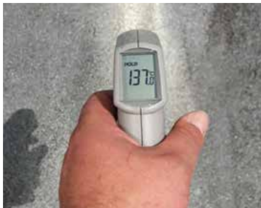
137 °C fokos felszíni hőmérséklet mérése egy vízszigeteléssel ellátott tető egy részén, amelyet berendezések felületéről visszaverődő sugárzás ér
