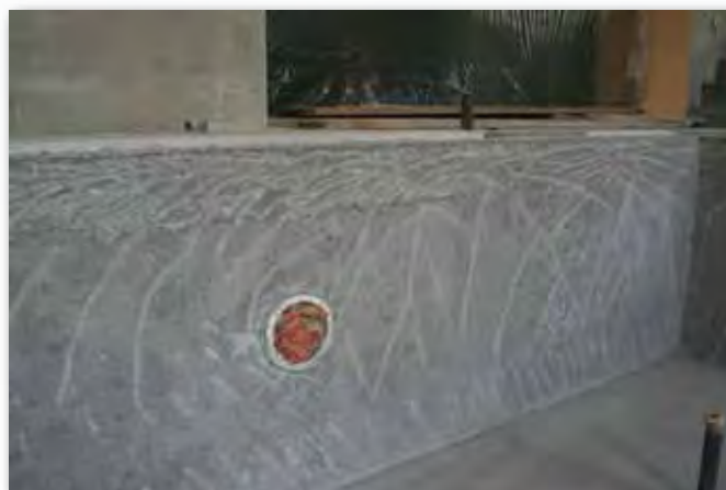
Ennél a medencénél a felület nagyfokú egyenetlensége miatt a MAPEGROUT T40 betonjavító habarccsal oldották meg a kiegyenlítést. A MAPEGROUT T40 10-35 mm vastagságban felhordható egy rétegben.
