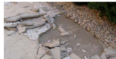
A rosszul szigetelt, vagy szigeteléssel nem ellátott földön fekvő terasz esetében előfordulhat, hogy a szerkezetbe bejutó talajnedvesség a burkolat tönkremenetelét okozza.
