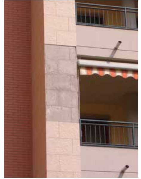
Distacco di rivestimento posato senza la realizzazione di giunti
