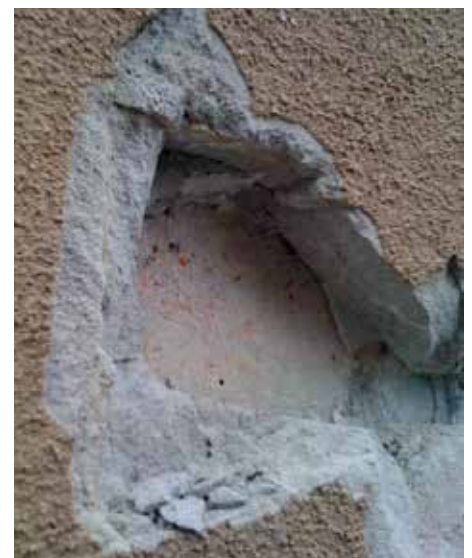
Cedimento di intonaco non idoneo all'incollaggio di un rivestimento
