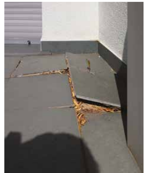
Fenomeni di distacco per compressione su pavimentazioni esterne dovute a mancanza di giunti
