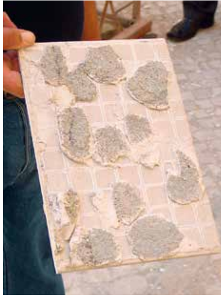
Distacco di piastrella per incollaggio effettuato in modo errato (a toppe)
