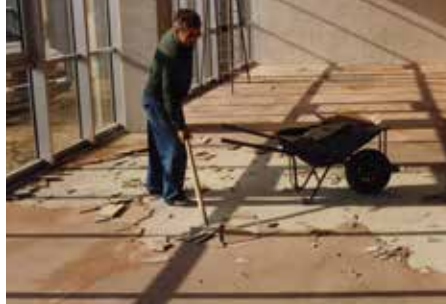
Distacco di rasatura realizzato su massetto non sufficientemente omogeneo
