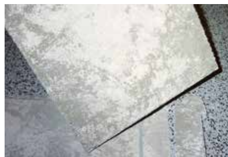
Distacco di piastrellatura per mancata pulizia del piano di posa
