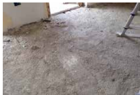
Sottofondo non idoneo alla posa del rivestimento
