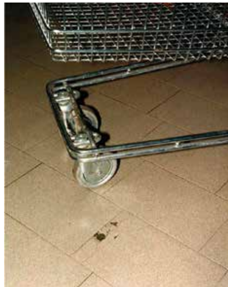
Rottura di piastrellatura sottoposta a carico concentrato
