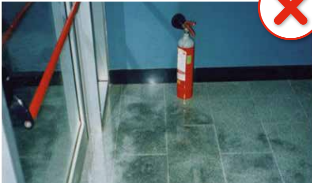
Posa su sottofondo non conforme
