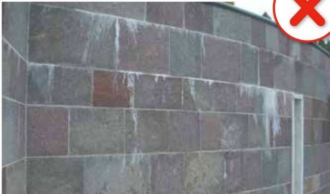
Posa su supporto non conforme
