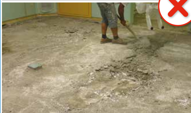
Massetto non conforme a UNI 11515
