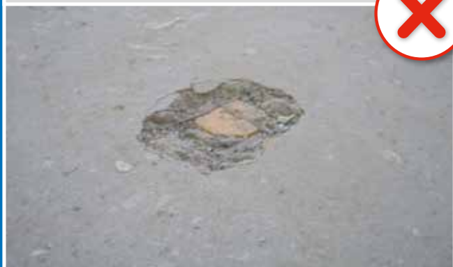
Massetto riscaldante non conforme a UNI 11515
