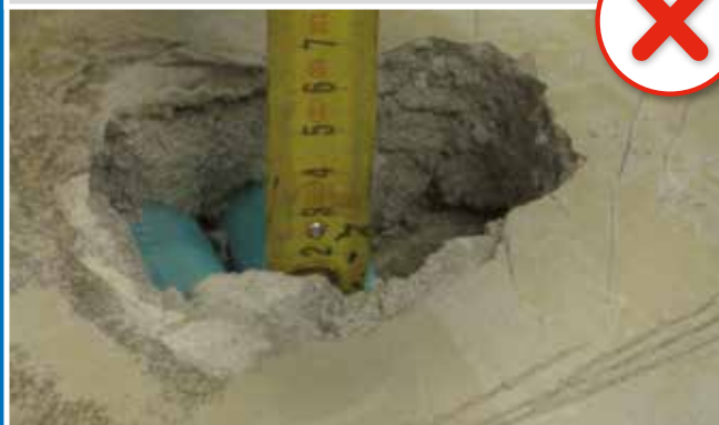
Copertura delle tubazioni non conforme a UNI 11515
