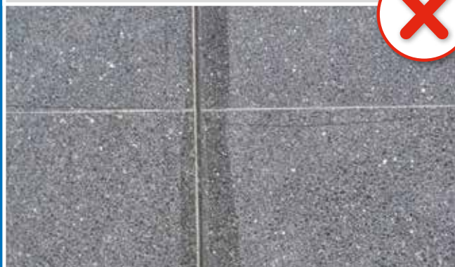
Sigillatura del giunto con materiale non conforme alla norma
