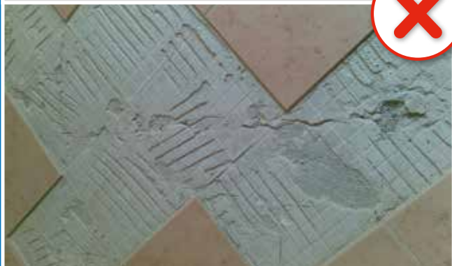
Realizzazione dei giunti non conforme a UNI 11493
