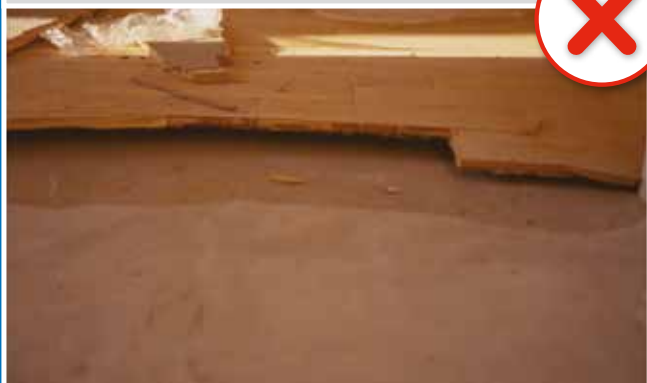
Massetto non conforme a UNI 11371
