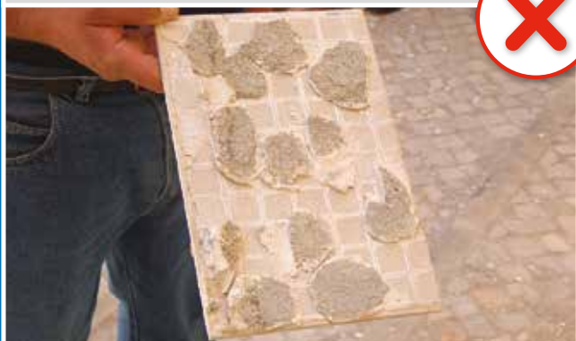
Posa non conforme a UNI 11493
