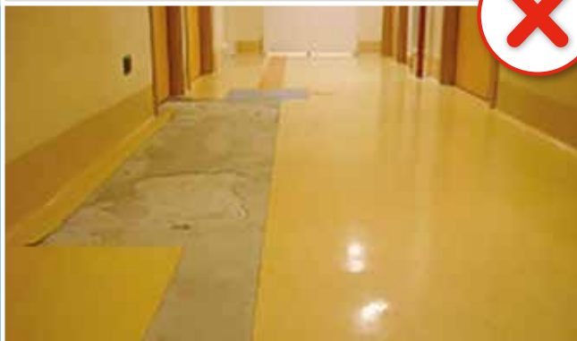
Lisciatura non conforme a UNI 11515
