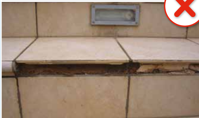
Posa non conforme a UNI 11493
