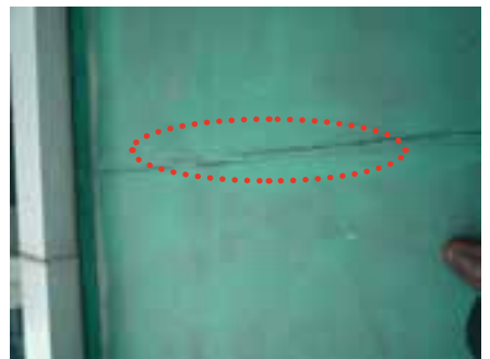
混凝土填缝料的卷材整体开裂。
