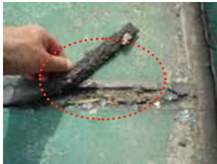
混凝土填缝料都已经剥落。
