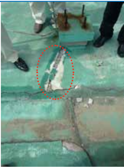
卷材面层开裂剥落。
