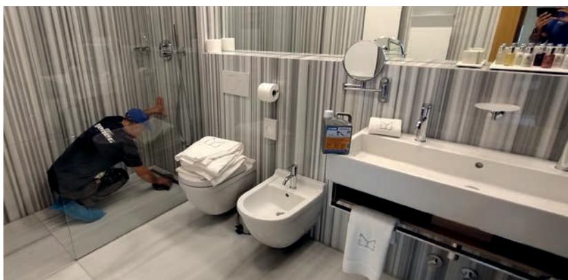
LIJEVO: Zaštita površina kamena sredstvom ULTRACARE STAIN PROTECTOR W PLUS.
