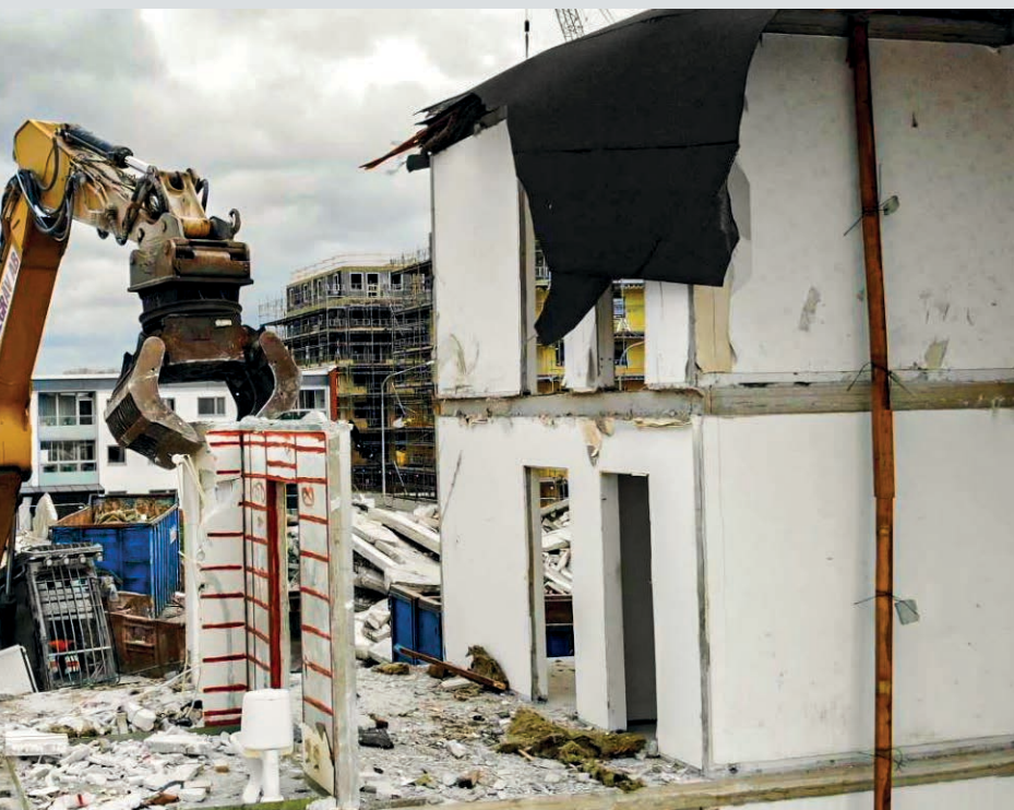
SLIKA LIJEVO: Prikaz uklanjanja predgotovljenih betonskih elemenata sa zgrade u fazi rušenja, a koji se skladište i ponovno upotrebljavaju u izgradnji nove zgrade (Švedska).
