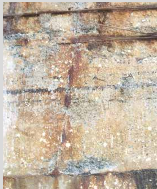
Typisk eksempel på chloridangreb
