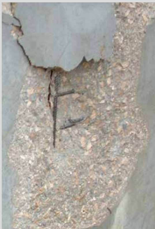
Nedbrydning i beton, forårsaget af fryse-/tø-cykluser
