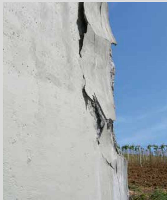
Løsrivelse af dele af beton, forårsaget af sulfatangreb
