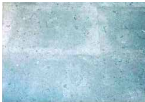
Randverfärbung in einem Kalksandstein durch ungeeigneten Fugenmörtel
