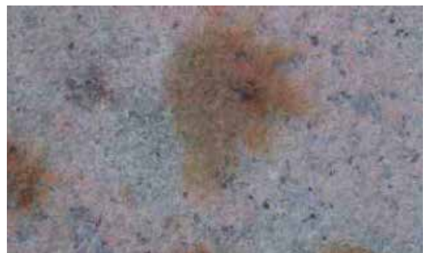
Oberflächenverfärbung, verursacht durch die Reaktion eisenhaltiger Minerale (z. B. Pyrit) mit alkalischer Feuchtigkeit aus dem Verlegesystem in Verbindung mit Sauerstoff
