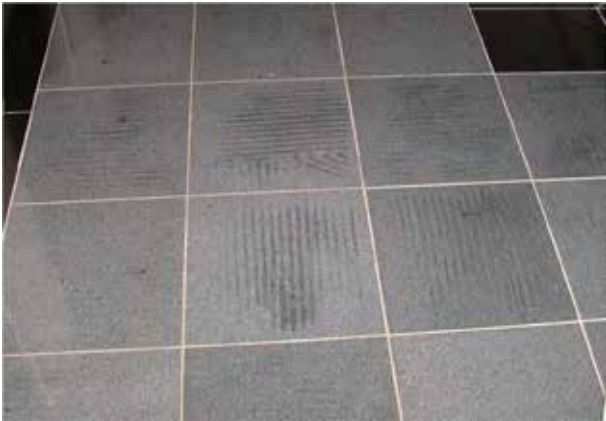
Veränderte Oberflächenoptik durch Einlagerung von Fremdstoffen in die oberflächennahen Kapillarporen des Gesteins
