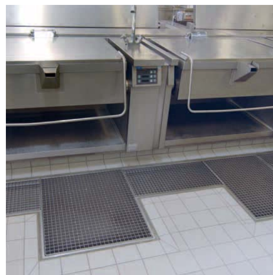
Im Bereich der Bodenabläufe ist der Belag einer extrem hohen mechanischen und chemischen Belastung ausgesetzt
