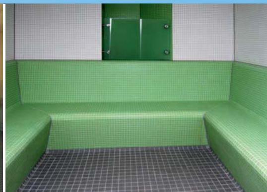
Mosaikbelag in der Dampfsauna
