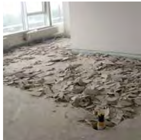
Die gesamte Verbundkonstruktion musste ein zweites Mal hergestellt werden.
