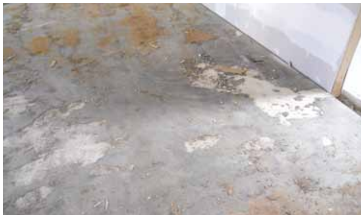
Altuntergrund mit Klebstoff- und Belagsresten
