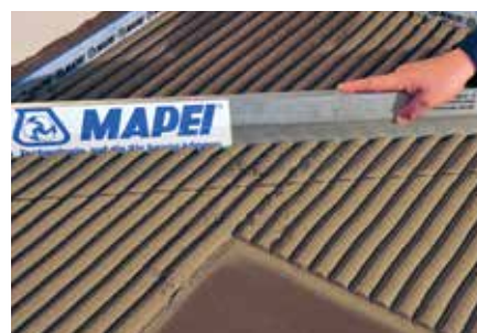
Unterbrechungen des noch frischen Mörtels der Tragstege sorgen für Verbindungen zwischen den Ablaufrillen zur dauerhaften Sicherstellung einer ausreichenden Wasserabführung
