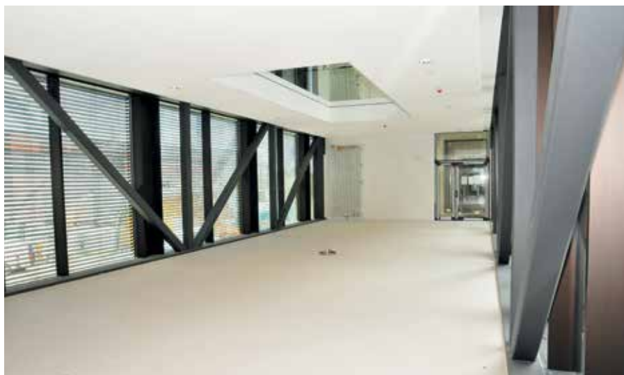
In den publikumsintensiven Fluren wurde ein Linoleumbelag in Sandbeige den Anforderungen entsprechend mit Systemprodukten von MAPEI verlegt.
