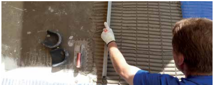
Unterbrechungen des noch frischen Mörtels der Tragstege sorgen für Verbindungen zwischen der Ablaufrinne zur dauerhaften Sicherstellung einer ausreichenden Wasserabführung.
