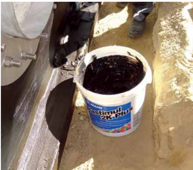
Zur fachgerechten Abdichtung kam die Bitumendickbeschichtung MAPEI PLASTIMUL 2K PLUS zum Einsatz.
