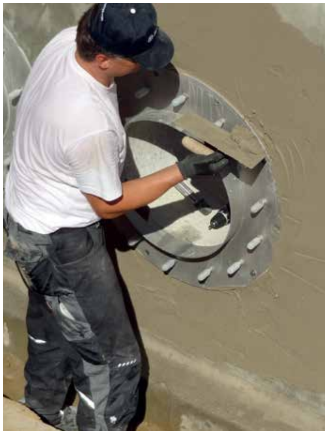
Besondere Aufmerksamkeit erforderten bei den Abdichtungsarbeiten die zahlreichen Durchdringungen in Form von Rohr- und Kabeldurchführungen, die einen Durchmesser von bis zu 500 mm hatten.
