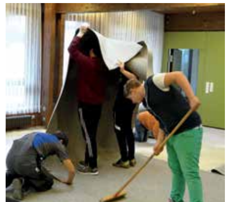
Nach der Verlegung wurde der Belag von den Schülern mit einem Anreißer und später mit einer Andrückwalze gründlich angerieben bzw. angewalzt.
