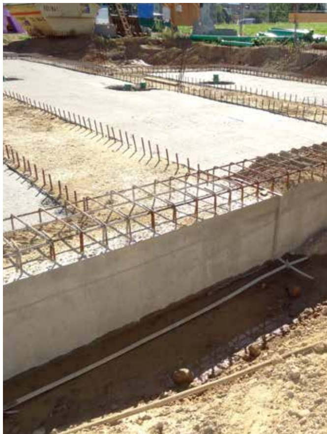
Bei dem Neubau galt es, die Kellerwände gegen Feuchtigkeit und Wasser zu schützen, d.h. eine Abdichtung gegen von außen drückendes Wasser und aufstauendes Sickerwasser vorzunehmen.
